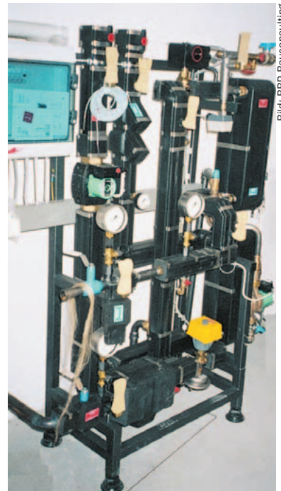
Wärme-Übergabestationen in den sanierten Gebäuden sorgen für große Temperaturerhöhung zwischen Vor- und Rücklauf
