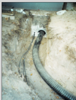
Wärme- und Stromnetz, Hauseinführung
