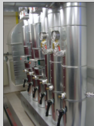
Verteiler und Pumpen
